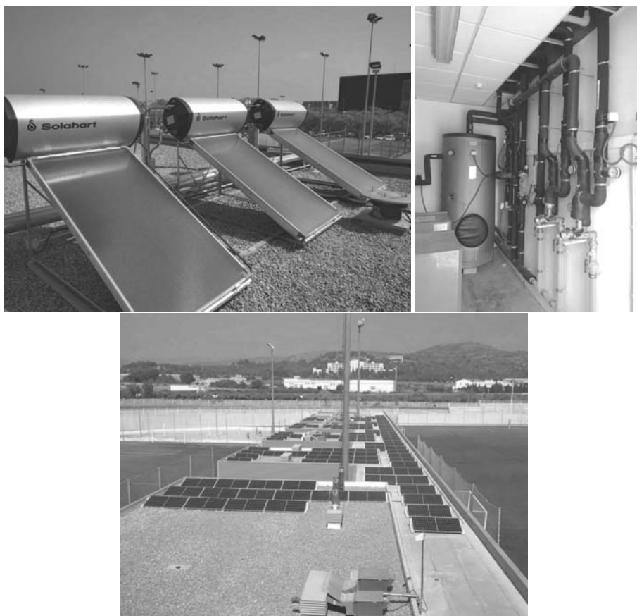
Figura 38: Instalaciones termosolares (arriba izquierda) y nuevo depósito de agua en el edificio de la zona de raquetas (arriba derecha). Instalaciones fotoeléctricas en la cubierta del edificio de vestuarios (abajo).
