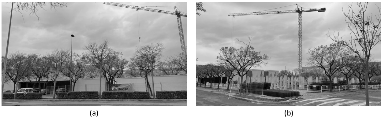
Figura 46: Obras de construcción del nuevo edificio de investigación. (a) Edificio de investigación 1, con el que se integra el nuevo como ampliación. (b) Estado de las obras en marzo de 2022.
